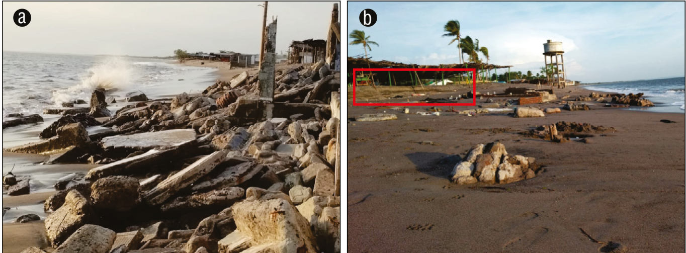
Figura 8. Impacto del aumento del nivel del mar en la infraestructura costera de Cedeño, litoral del Pacífico de Honduras (LPH). Restos de infraestructura sumergida por el aumento del nivel del mar (a) y erosión costera etiquetada en rojo y negocios locales destruidos por el aumento del nivel del mar (b).
